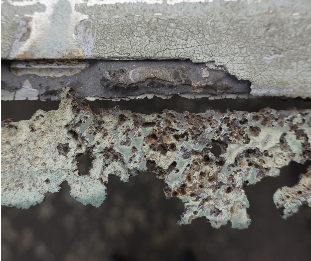
Magnesium korrodiert. Bildquelle: HTW Berlin
